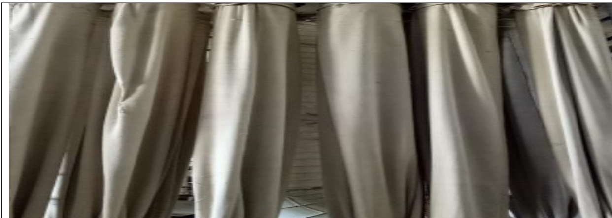
布袋除尘设施
